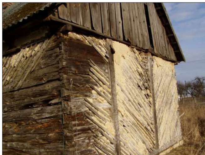
Gliniany tynk zewnętrzny. Złoczew, ul. Sieradzka 61. Fot. Paweł Kieroń
